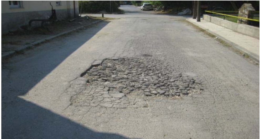
Εικόνα 4-1: Ρηγματώσεις στο οδόστρωμα επί ανώνυμης οδού
